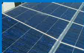
太陽光パネル
